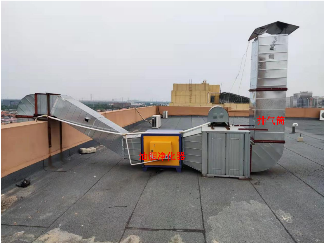
食堂油烟处理措施
